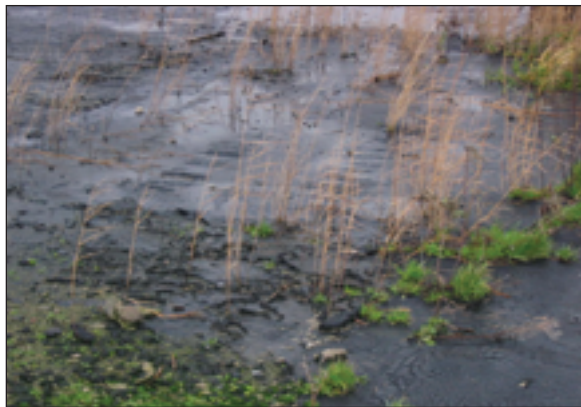
Состояние крыши до ремонта.
