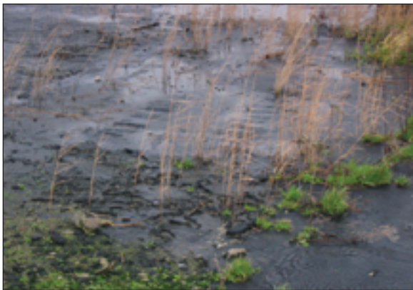
Состояние крыши до ремонта.
